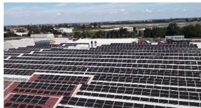
イタリア工場の太陽光パネル
